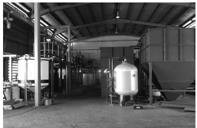
NEDO マレーシア実証プラント（Accot 社）
